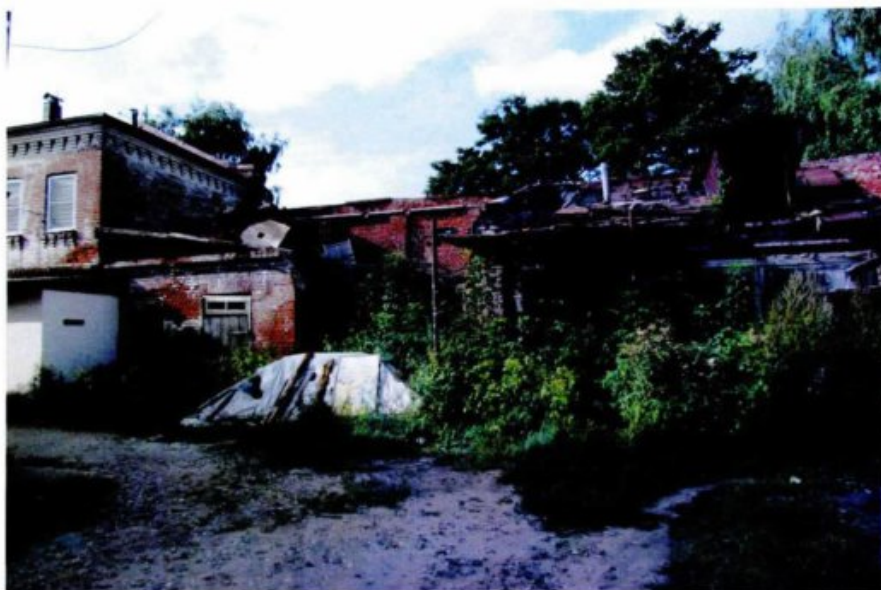
«Усадьба городская, сер. - кон. XIX в. Хозпостройка и конюшня - кон. XIX в. », по адресу: Костромская область, г. Кострома, ул. Комсомольская, 25/30 лит. Г Вид на юго-западное крыло здания
