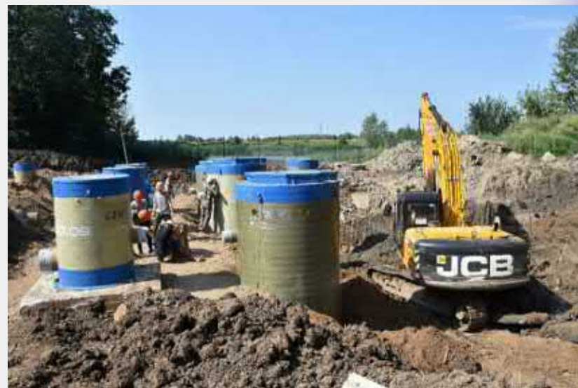
Очистные сооружения, улица Судостроительная
